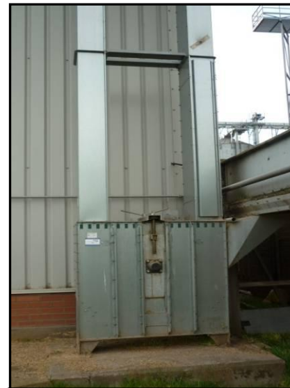
Simpsons- E1 Elevator
