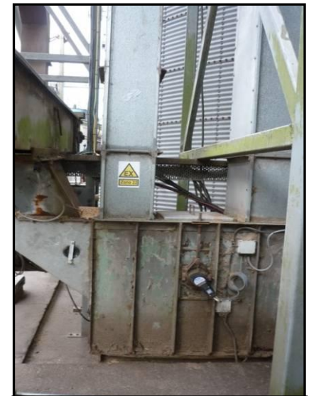
Simpsons- E4 Elevator
