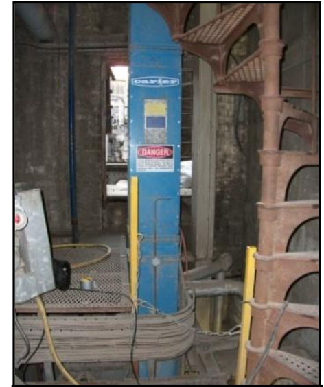
Bairds- Elevator E172/3
