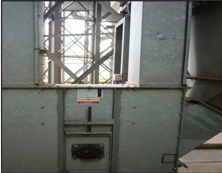
Simpsons- Elevator E3
