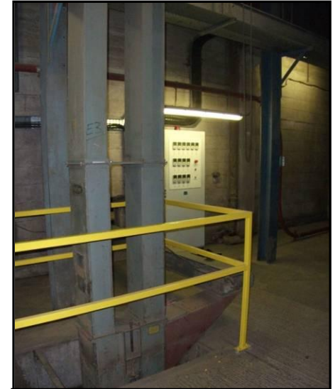
Bairds- Elevator E3
