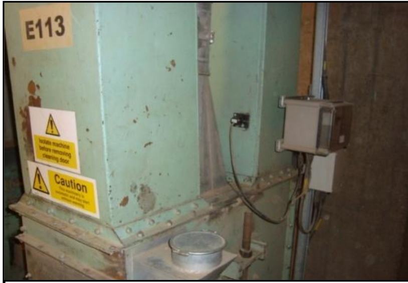
Boortmalt- Elevator E113
